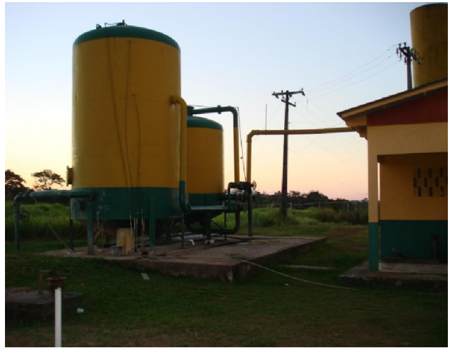
Figura 29. Estação de tratamento de água – DEAS (Foto: Jakeline Pinheiro)
