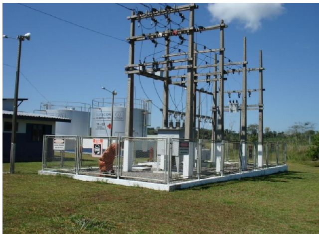
Figura 32. Usina de Energia Elétrica (Foto: Jakeline Pinheiro)
